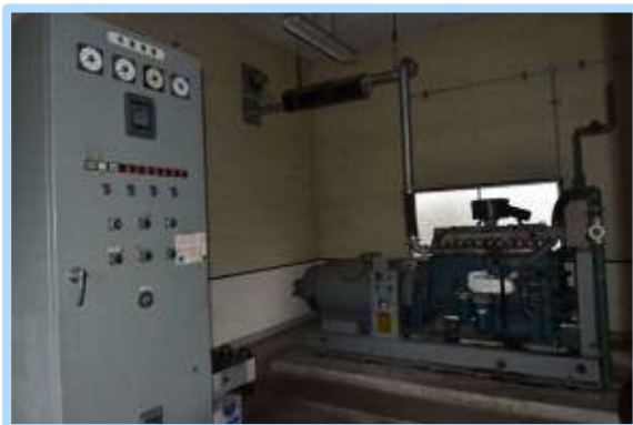
写真 3-6: 八幡台水源地の自家用発電機
