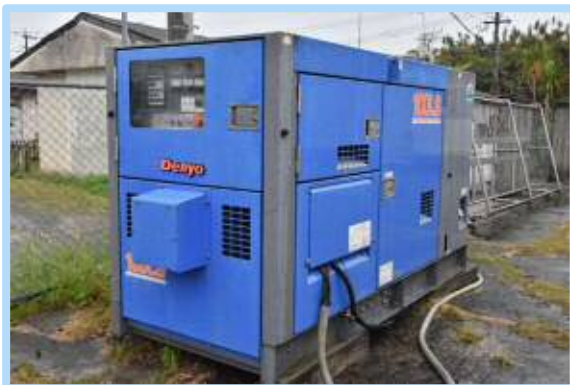
写真 3-5: 桜山水源地の自家用発電機
