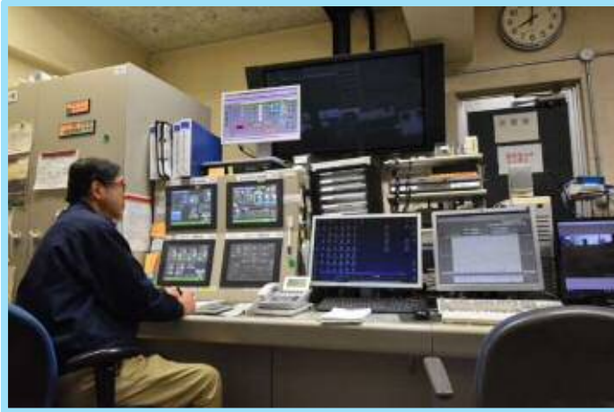
写真 3-7：中央監視室での操作風景
