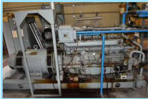
写真 3-4: 中央水源地の自家用発電機
